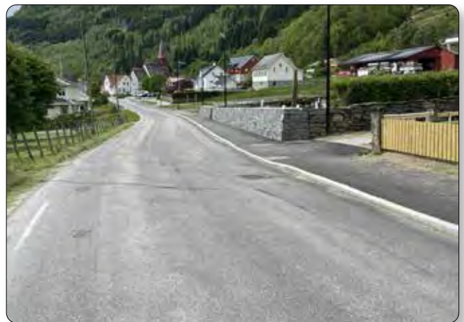
Arbeidet ved Lustrabui, kyrkjegarden og oppvekstsenteret i Luster vart ferdigstilt i vår.
